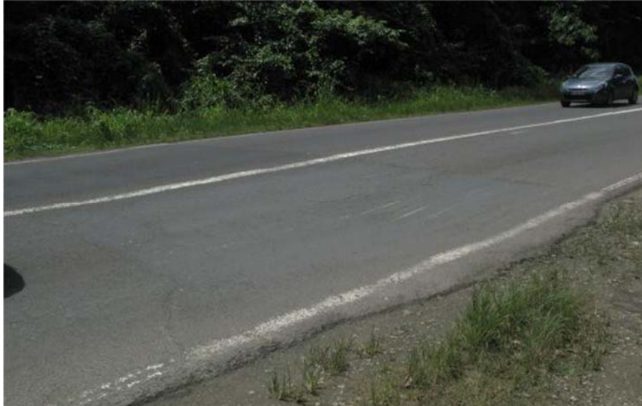
Figure 21 : Tassement de la route RD 32 pouvant être lié à l'élévation du toit de la nappe.
